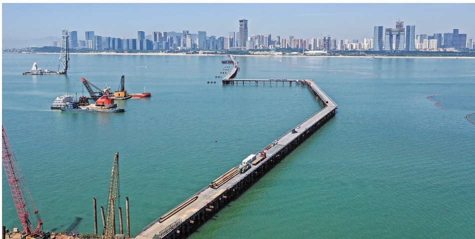
施工栈桥顺利合龙,将为A1标段大范围施工创造有利条件。 记者 陈理杰 摄
