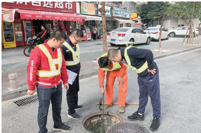
厦门窨井盖全面纳入监管,城市“智”理更加方便快捷。
