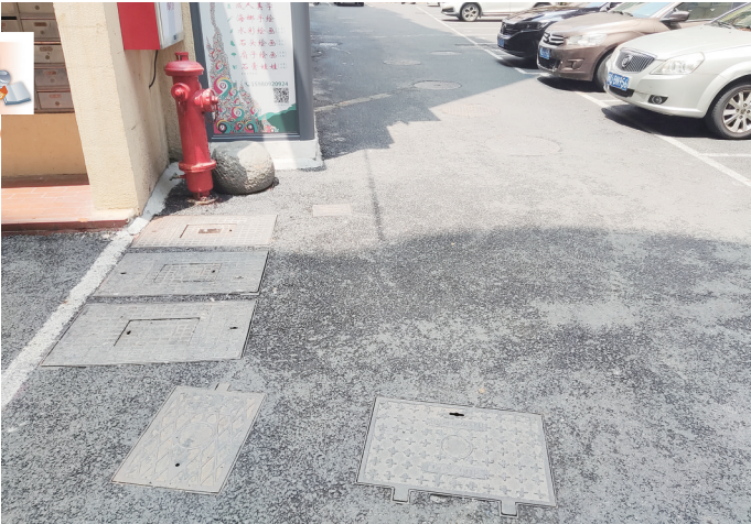
在金龙公寓,部分路段存在高低不平的“井盖阵”。记者 陈起鸿 摄
