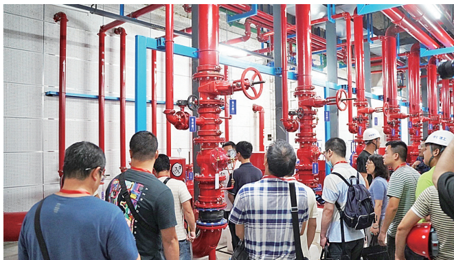
福厦高铁通过消防验收。
