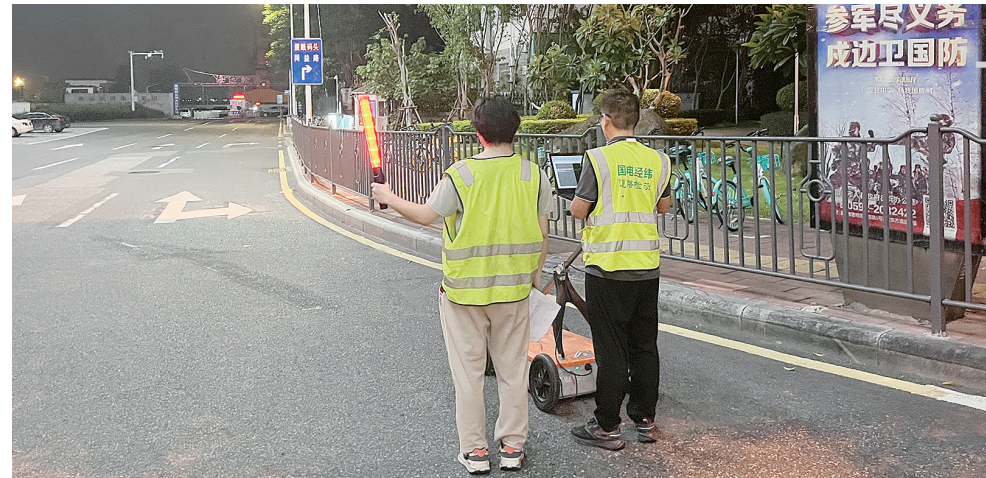
道路病害。 作业人员使用手推式雷达探测
